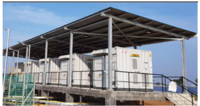
图表 8. 集中式逆变器专用机房
