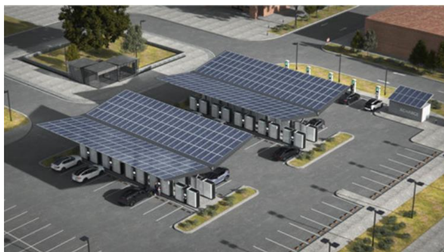
图 8：光储充一体化充电站
