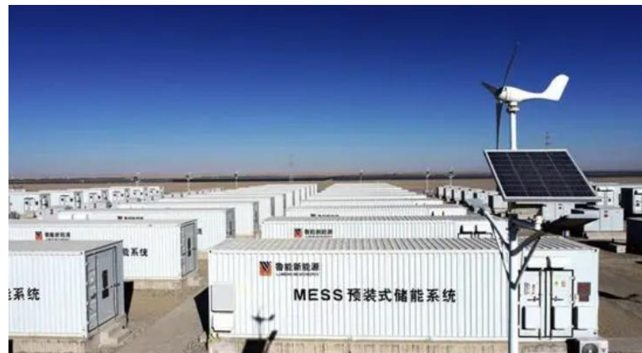
图 7：青海海西蒙古族藏族自治州弘柳储能电站
